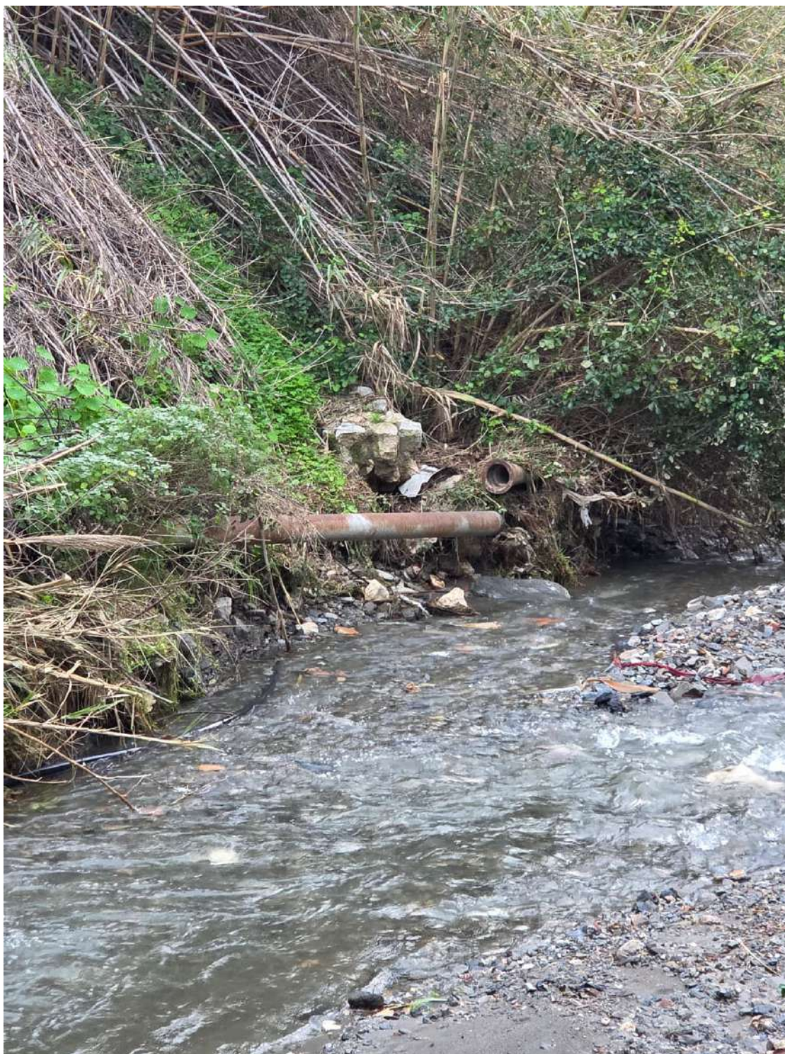
Tubería de suministro rota (EL FARO)
