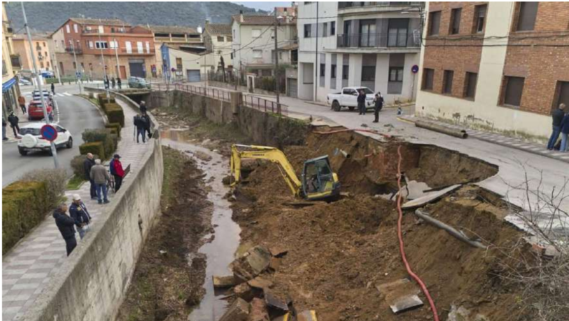
Derrumbe en la población de Anglès que ha dejado el pueblo sin agua / Diari de Girona
