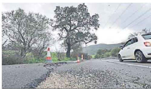
Un vehículo circula por la carretera de Botafuegos, muy dañada.
