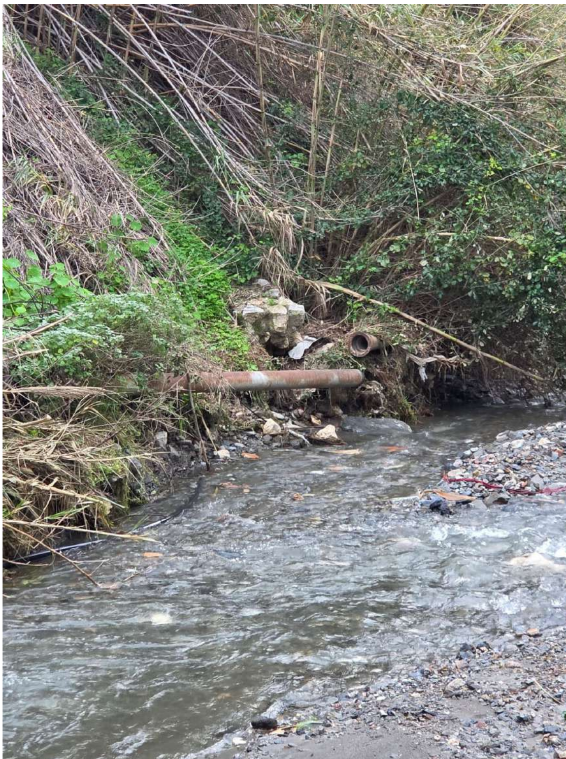
La tubería de Ítrabo afectada / G.H.
